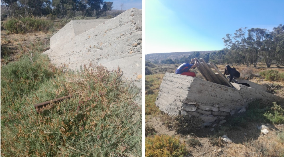
Figura 2: A la derecha, detalle de riel sobresaliente de la estructura del pozo; a la izquierda, niños jugando en él. Fuente: Elaboración propia.
